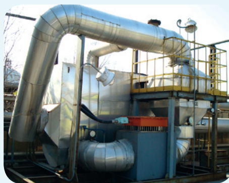
30,000 \text{Nm}^3/\text{h} 污水处理场废气催化燃烧处理装置
