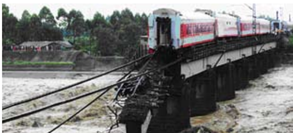
宝成铁路德阳境内石亭江铁路大桥被洪水冲垮，沿途移动通信线路严重受损
