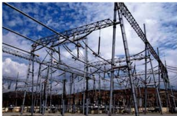
500kV七甸变电站
