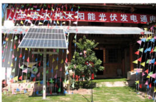
玉碗水村太阳能光伏发电
