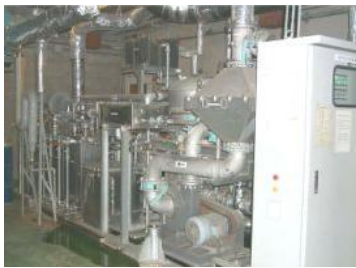
溶剂回收装置
