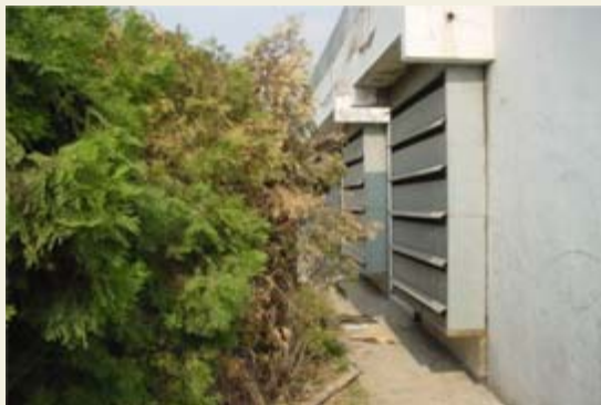
空压机室窗户上安装的降噪装置
