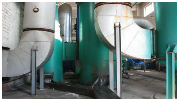
废气处理装置：既可以脱硫除尘，又可以降低污水的色度、PH 值，减少污水处理时药剂投放量
