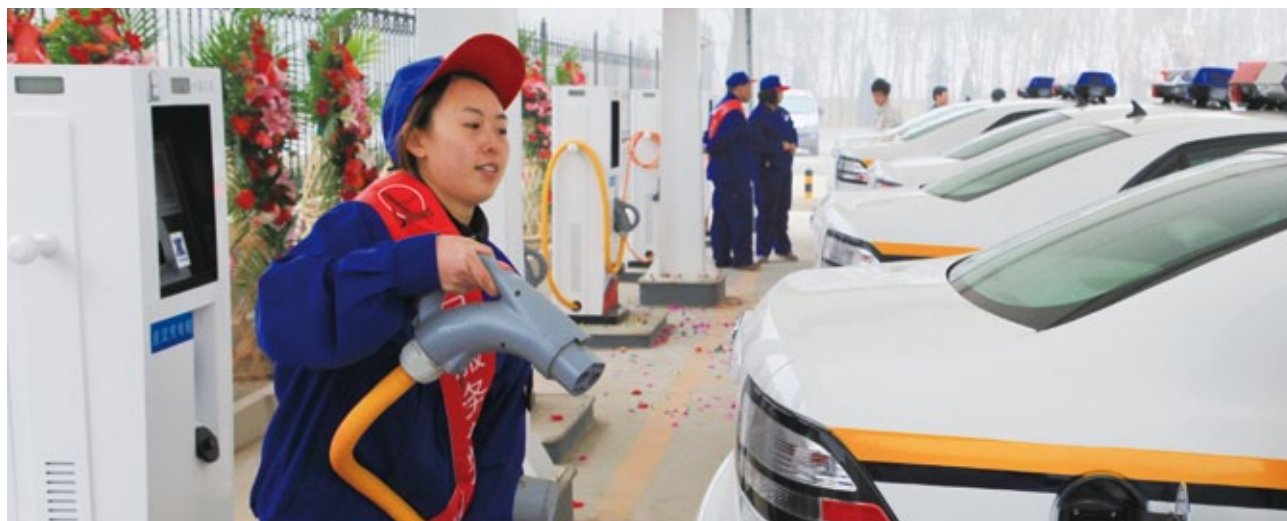
中国石化北京石油津塘兴顺加油充电站
