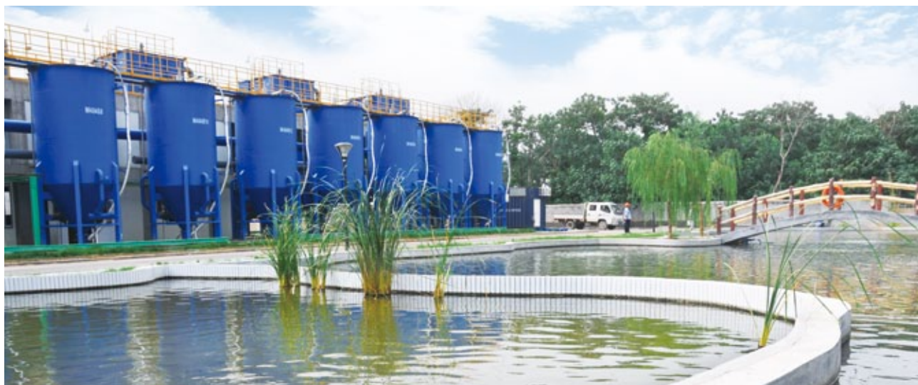
中国石化齐鲁乙烯污水处理厂
