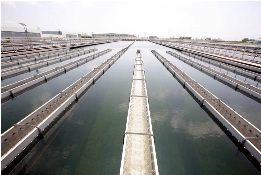
自来水闵行公司下属水厂沉淀池
