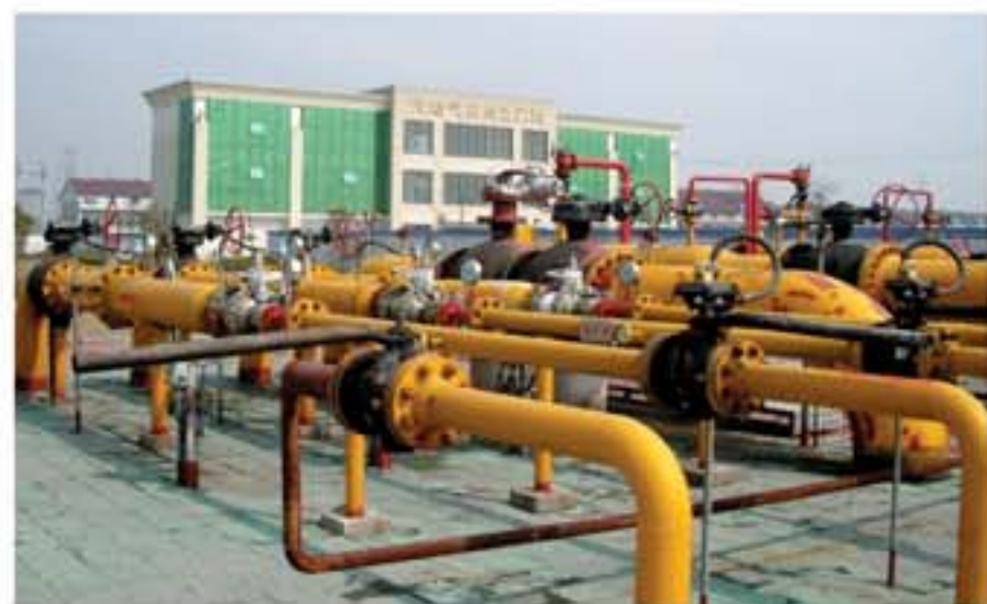
杭州城市天然气管网项目中的一座天然气门站
