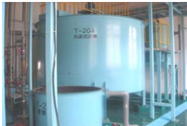
电镀废水处理装置
