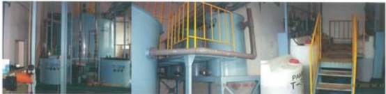
电镀废水处理设备
