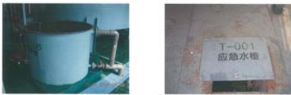
电镀废水处理应急设施
