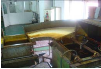
镀铬槽及回收槽
