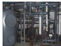
排水再利用装置
