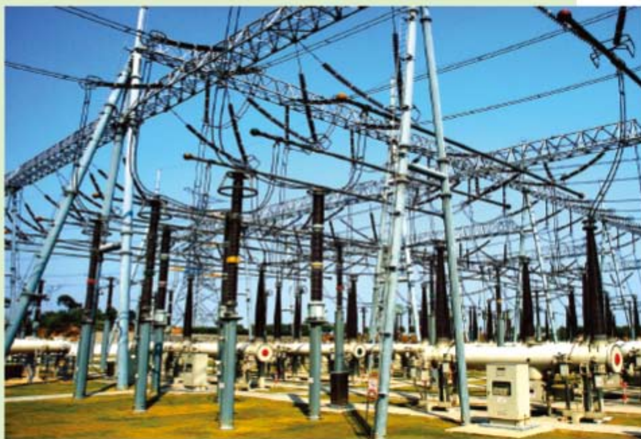
东莞500千伏横沥变电站占地4.5公顷，比常规变电站节约用地一年以上
