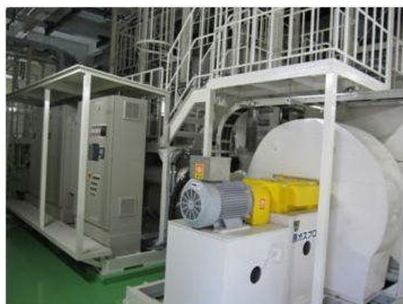
世界上最先进的溶剂回收装置
