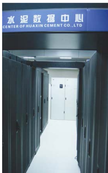
▲ 公司2007年新建的一流数据中心
