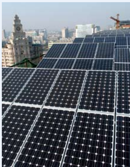
国家电网浙江公司250千瓦太阳能屋顶光伏并网示范电站
