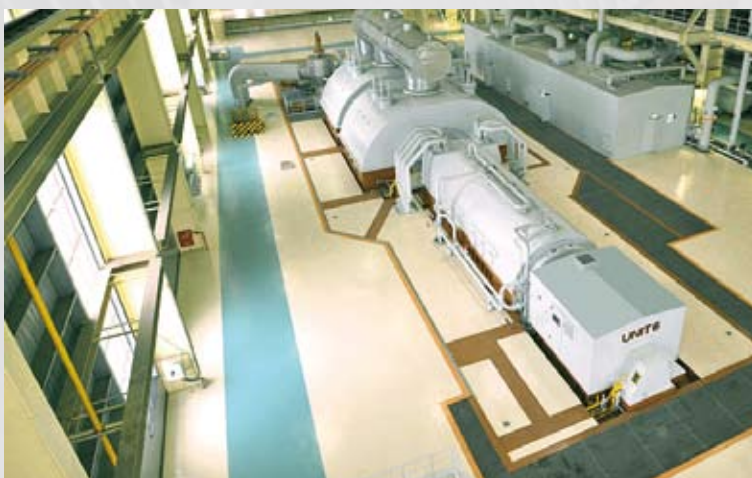
国电浙江北仑电厂1000MW发电机组保世博
