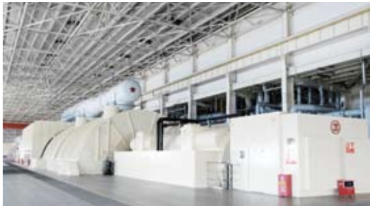
广东大唐国际潮州发电公司在原有装机容量2×60万千瓦的基础上，建成投产2×100万千瓦机组，总装机容量达到320万千瓦。
