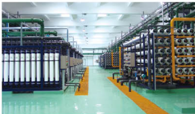
○ 河北王滩发电公司海水淡化系统
