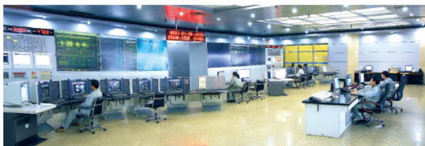
○ 火电厂集中控制室
