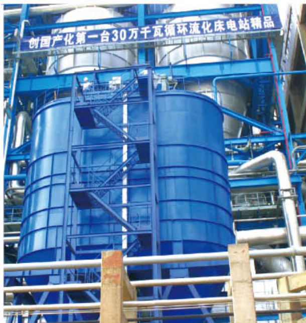
○ 云南红河发电公司300兆瓦循环流化床锅炉
