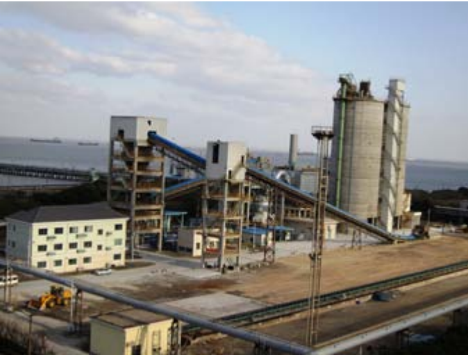
2011 年底建成投产的宝钢发展有限公司高炉矿渣资源综合利用改造项目
