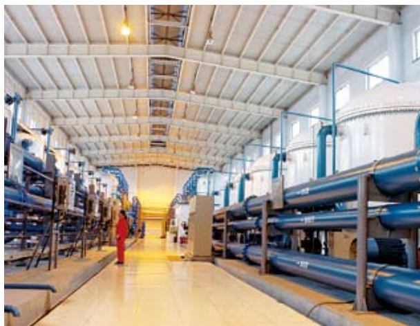
辽河油田稠油污水处理站
