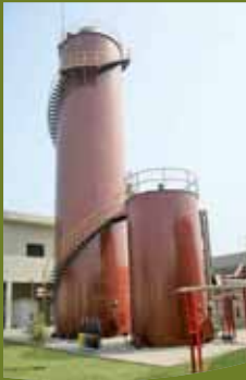
靠近秘鲁利马的美洲饮料的Huachipa厂的废水处理设备
