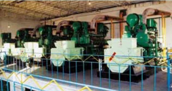
南煤集团 10×500 千瓦煤层气发电机组
