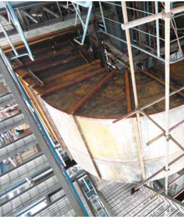
国投曲靖新装的燃烬风风箱
