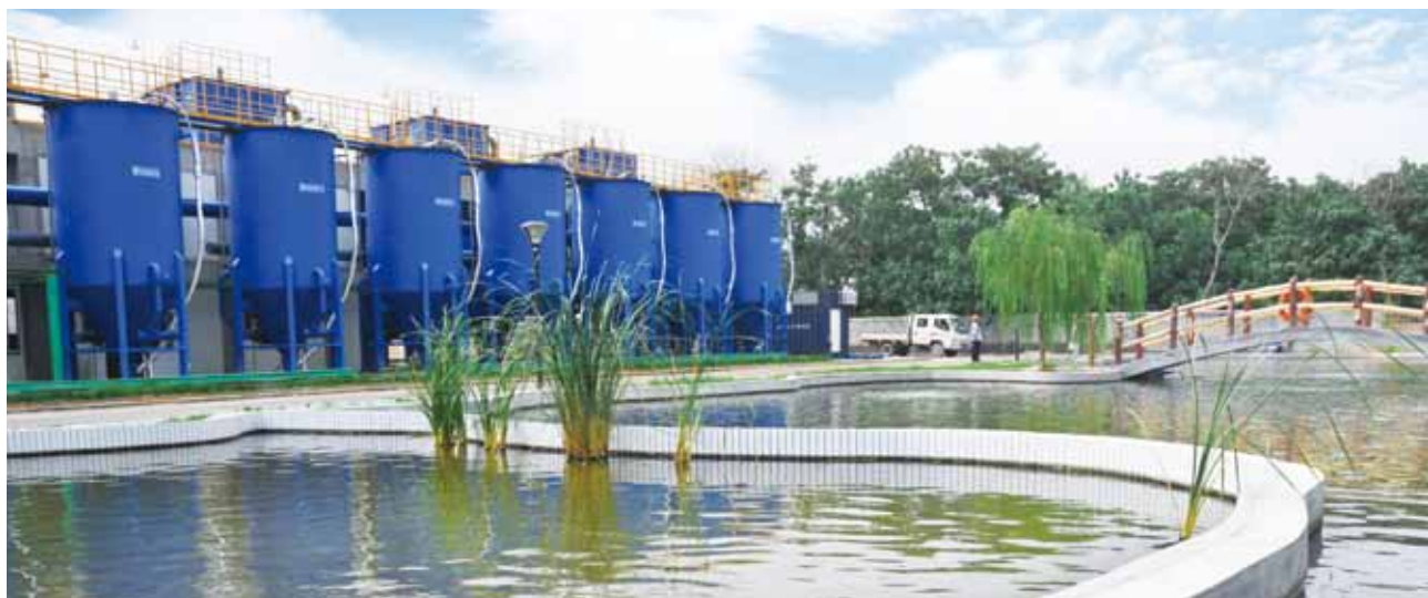
中国石化齐鲁乙烯污水处理厂
